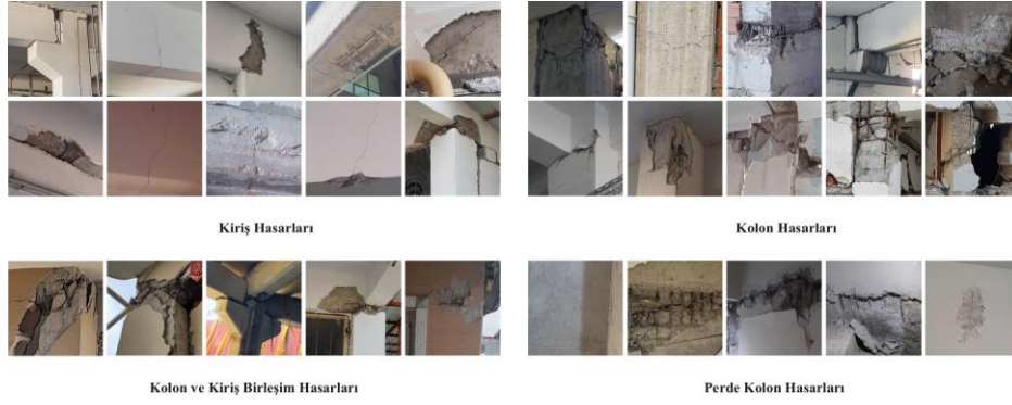
Şekil 4: Veri seti içerisindeki yapısal hasar örnekleri.
